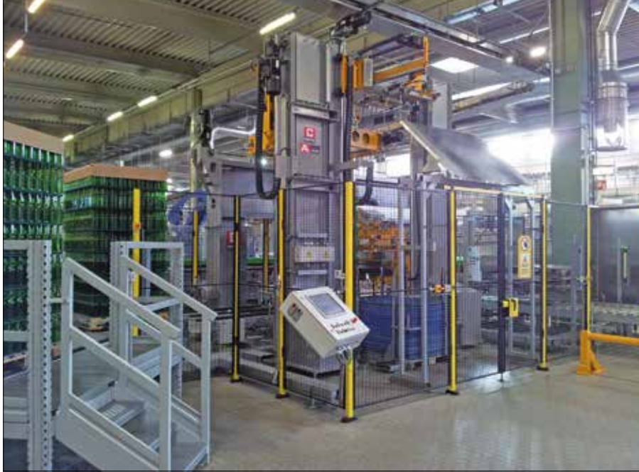
Der Neuglasabschieber ist mit sechs Achsen ausgerüstet. Der Zwischenlagenroboter hat die Aufgabe sowohl die Toptrays von der entfolierten Palette als auch die Zwischenlagen zu entsorgen.
